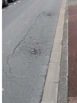
Réseau Véolia défoncé
